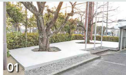
01 施工場所にベタ基礎を設置(業者に依頼)。桜の木の周囲やポールなどを避けるように多角形になっている。また、奥と手前に2~3度の傾斜をつけて、水はけをよくした
